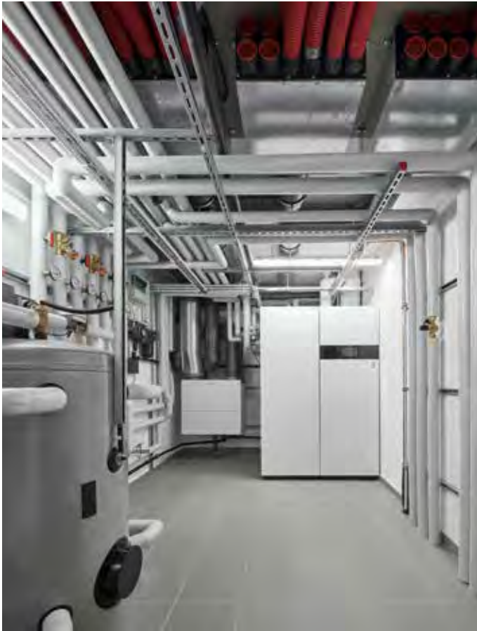
Die Technikzentrale des Hauses lag der Bauherrschaft besonders am Herzen: Neben einer Brennstoffzelle gibt es eine Wärmepumpe und eine Lüftungsanlage mit gekoppelter Photovoltaikanlage.
